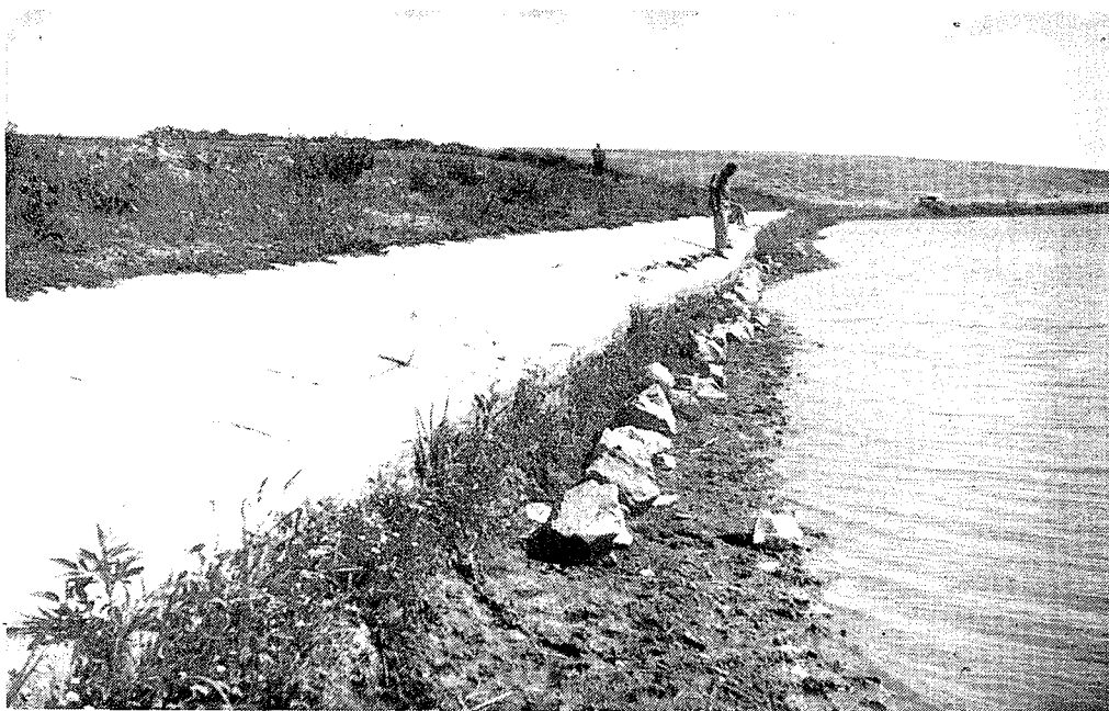
Slika 16. BETONSKA OBLOGA NASUTE BRANE NA VODOTOKU JOŠAVA (NAKON ISPUŠTANJA VODE IZ JEZERA)
